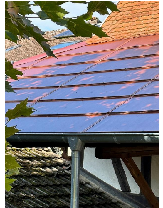
Abb. #: Dem Dach angepasste PV-Module. Landesamt für Denkmalpflege Hessen
