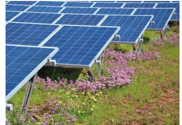
Abb. #: Südausrichtung aufgeständertes PV. Bauder Solar Light: Photovoltaiksystem für Gründächer - Ratgeber
